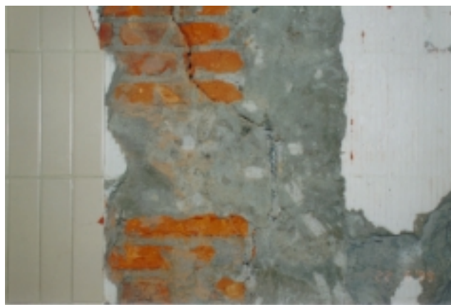
Figura 4.15 - Detalle de anclaje inadecuado en un muro divisorio de mampostería confinada
