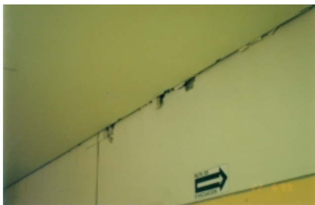
Figura 4.12 - Daño en elementos no estructurales
