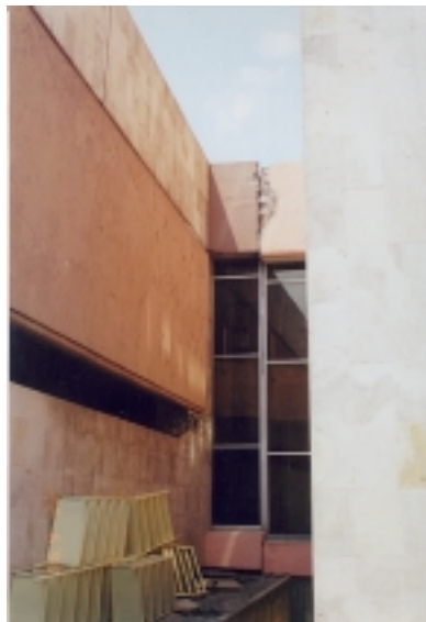
Figura 4.9 - Aplastamiento en juntas constructivas
