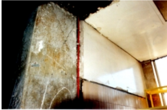
Figura 4.10 - Agrietamiento inclinado en columnas del primer nivel del edificio C
