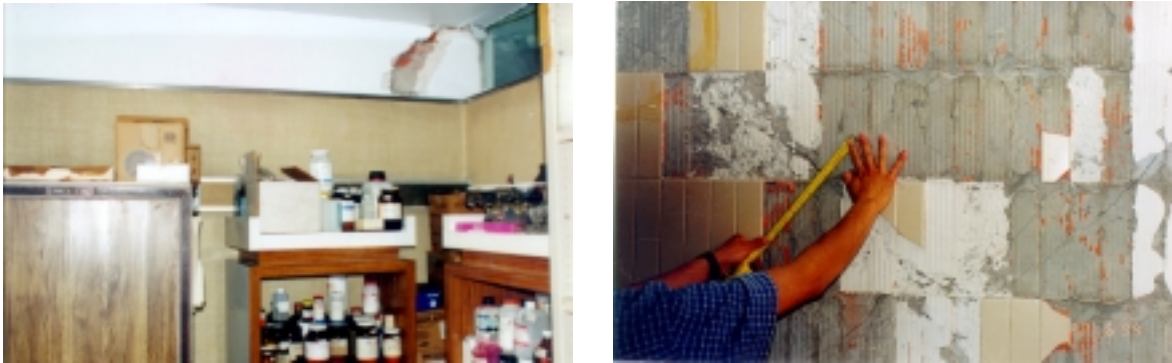
Figuras 4.4 y 4.5 - Agrietamiento en muros divisorios y muros de la junta constructiva entre cuerpos
