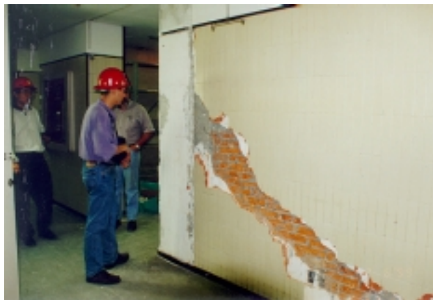
Figura 4.14 - Daño en muros divisorios de mampostería confinada
