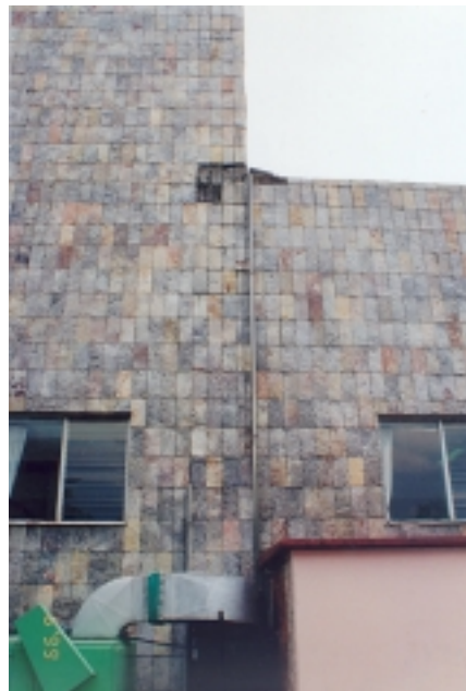
Figura 4.6 - Aplastamiento y desconchamiento de la fachada por golpeteo entre cuerpos
