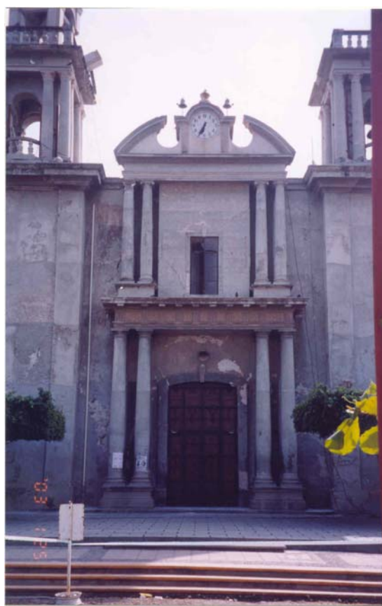
Figura 10.15 Grietas en cuerpo de torre y muros
