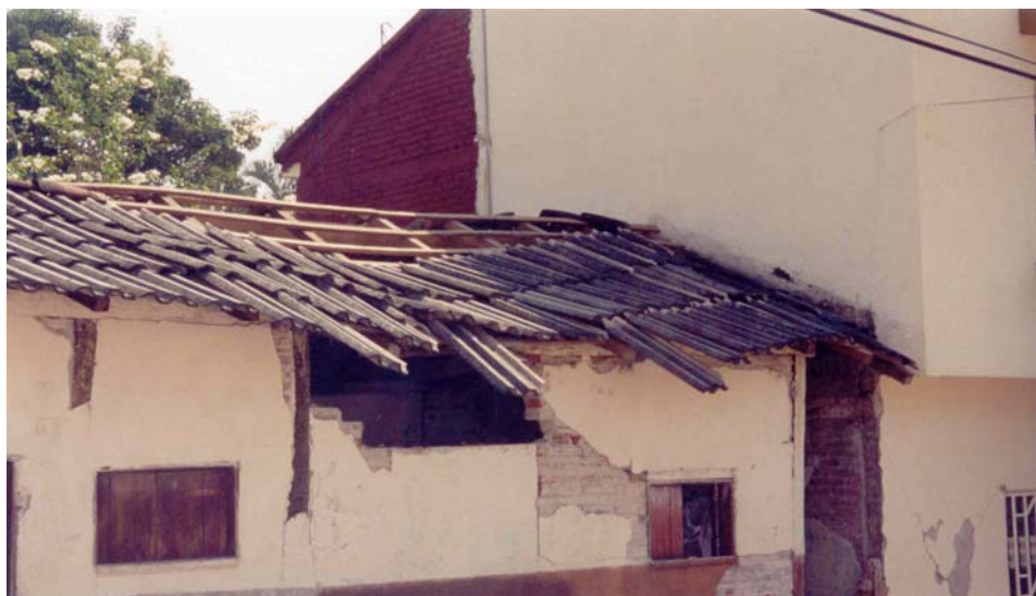
Figura 7.52 Vivienda número 3 con daño tipo III
