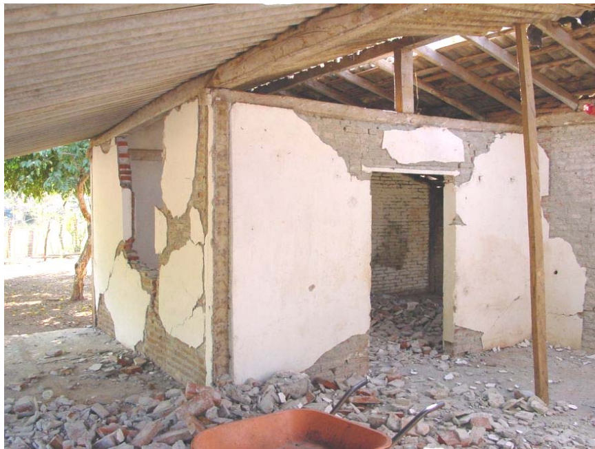
Figura 7.117 Daños en viviendas de mampostería simple
