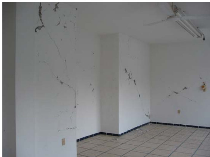
Figura 7.29 Daño observado en la planta baja
