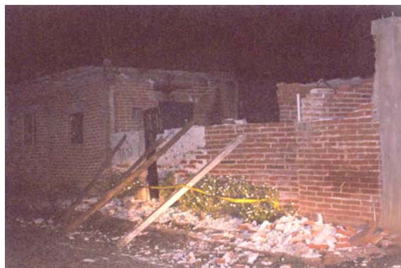
Figura 7.99 Caída de bardas de mampostería simple
