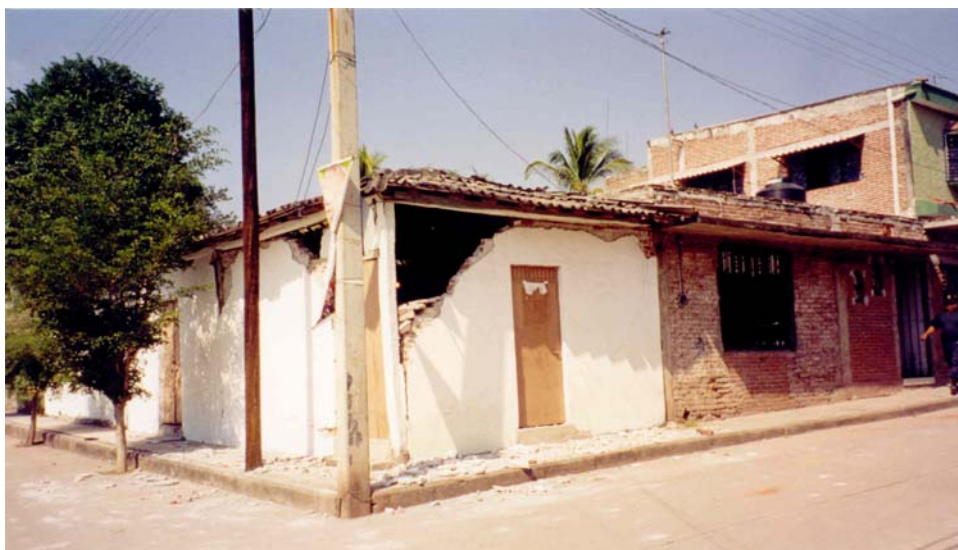
Figura 7.53 Vivienda número 13 con daño tipo III
