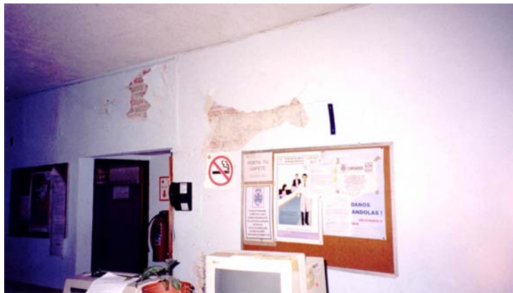
Figura 11.5 Ejemplo del daño en muros divisorios
