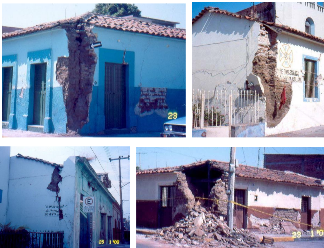
Figura 7.8 Grietas verticales y colapso de esquinas
