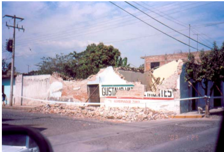
Figura 7.38 Daño en construcción de mampostería sin confinar
