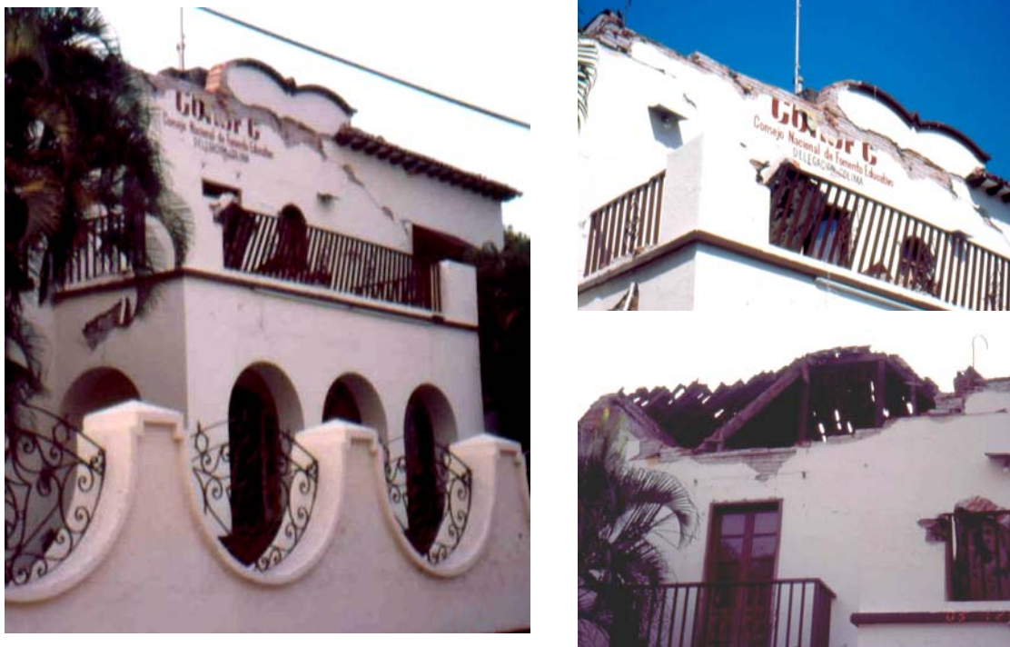
Figura 8.5 Daños en el edificio del CONAFE
