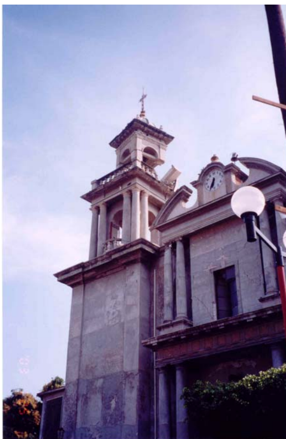
Figura 10.14 Vista del daño en el campanario norte
