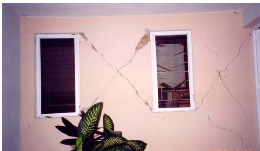
Figura 7.16 Daño típico en muros de mampostería confinada
