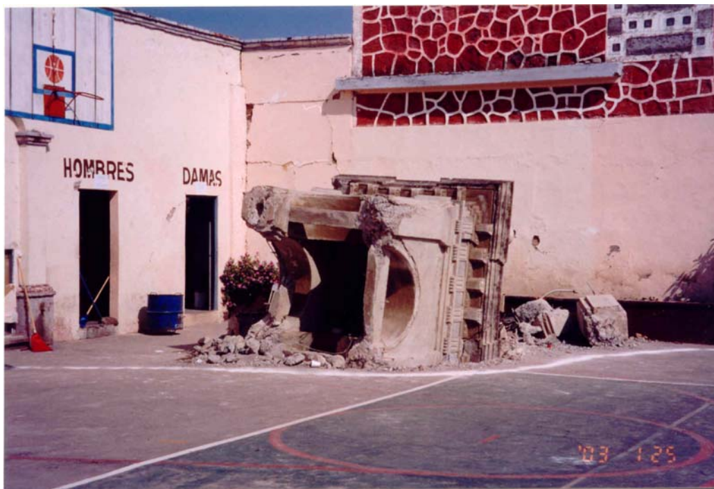
Figura 10.13 Caída del segundo nivel del campanario sur
