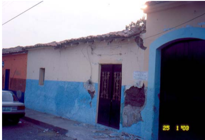
Figura 7.57 Daño ligero en vivienda de adobe
