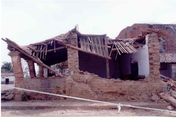
Figura 7.105 Colapso de muros y techos
