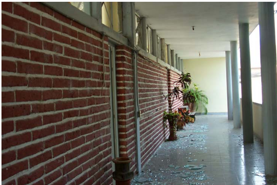
Figura 8.18 Rotura de vidrios en un edificio escolar
