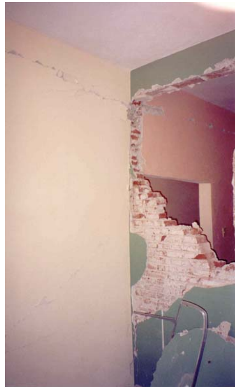
Figura 7.51 Daño en muros interiores de la vivienda 10
