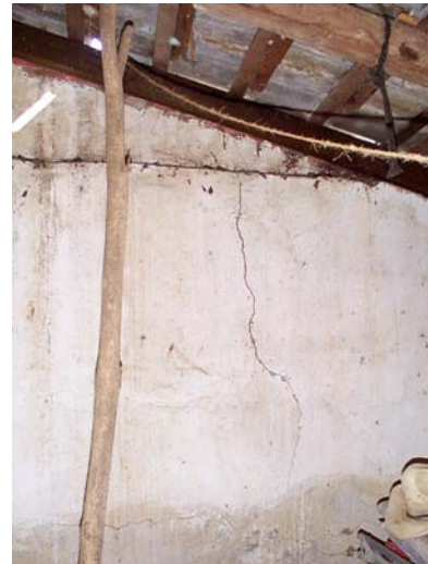
Figura 7.79 Agrietamiento vertical en muros cabeceros
