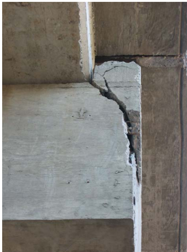
Figura 6.6 Daño en tope del puente “Manzanillo”
