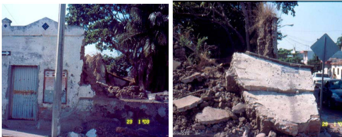
Figura 7.121 Bardas de adobe colapsadas
