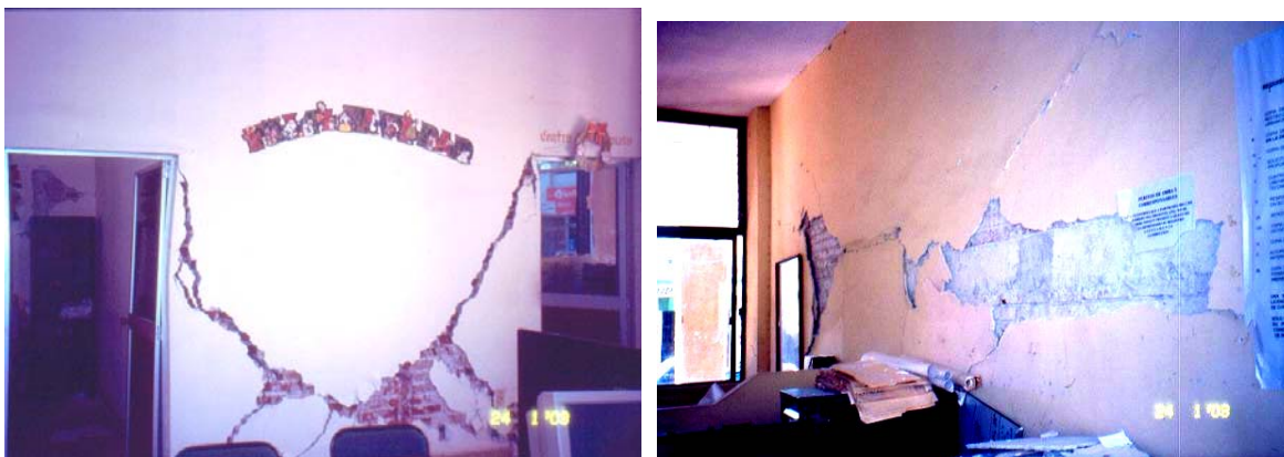
Figura 11.20 Daño en muros divisorios de mampostería
