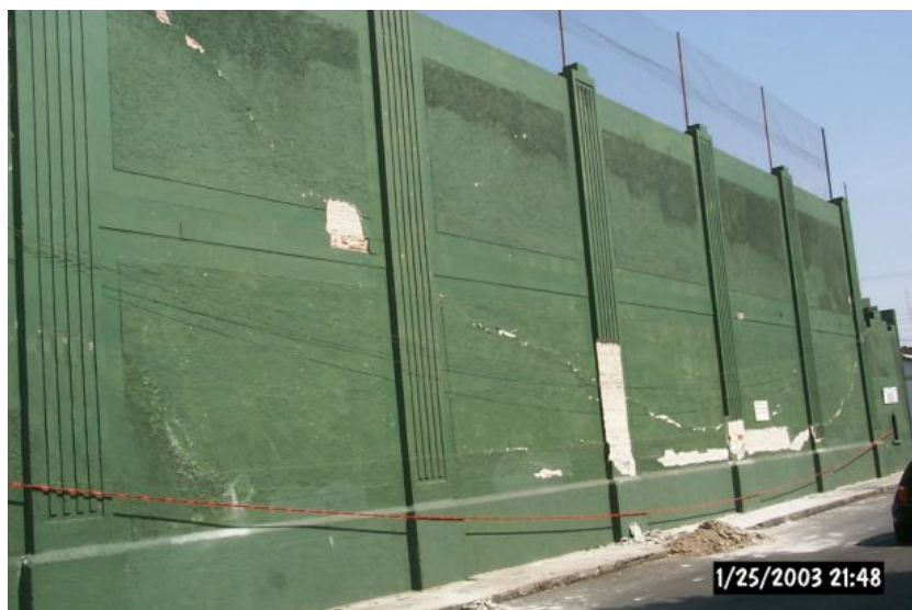
Figura 7.125 Agrietamiento en el muro de un frontón
