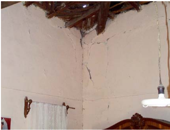
Figura 7.89 Agrietamiento en la intersección de muros
