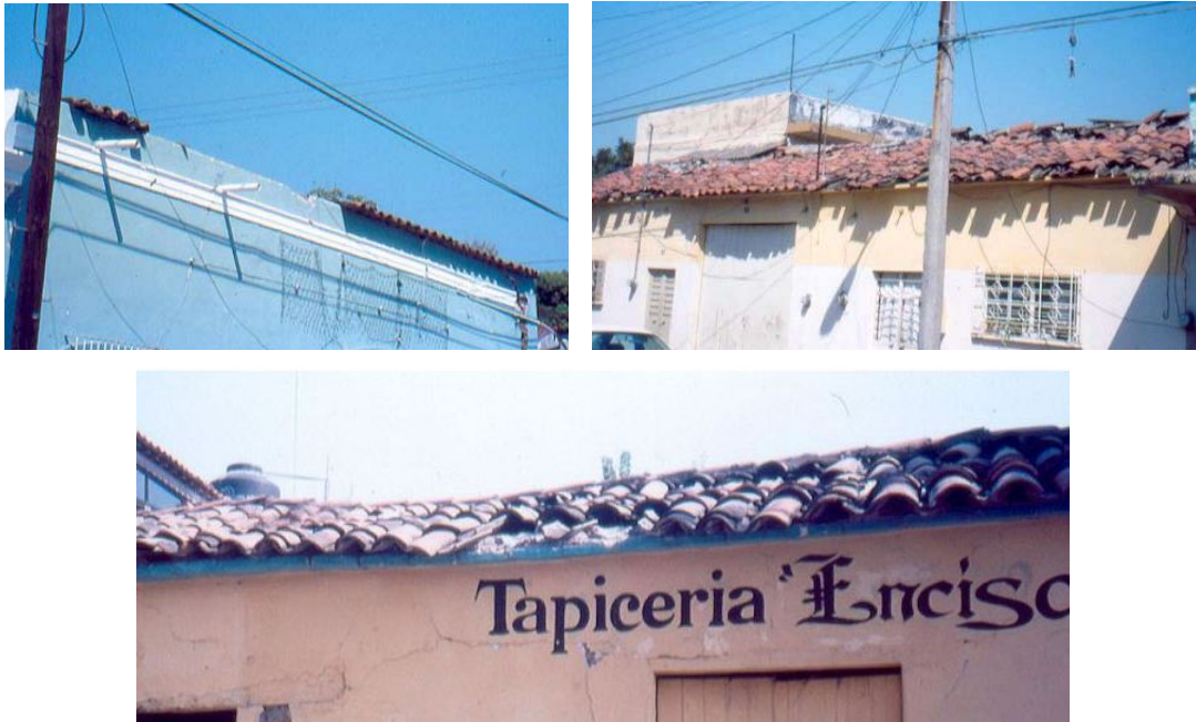
Figura 7.137 Caída de tejas sobre la vía pública
