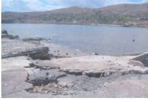
Daños en muelle
