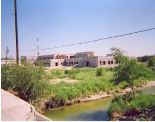
Figura 2.177 Hospital en construcción que sufrió inundaciones
