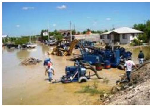
Figura 2.174 Bombas usadas durante la emergencia
