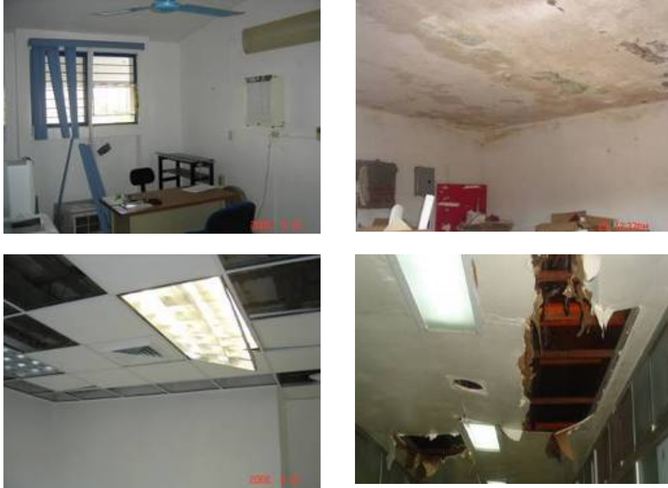
Figura 2.128 Principales daños en infraestructura de salud
