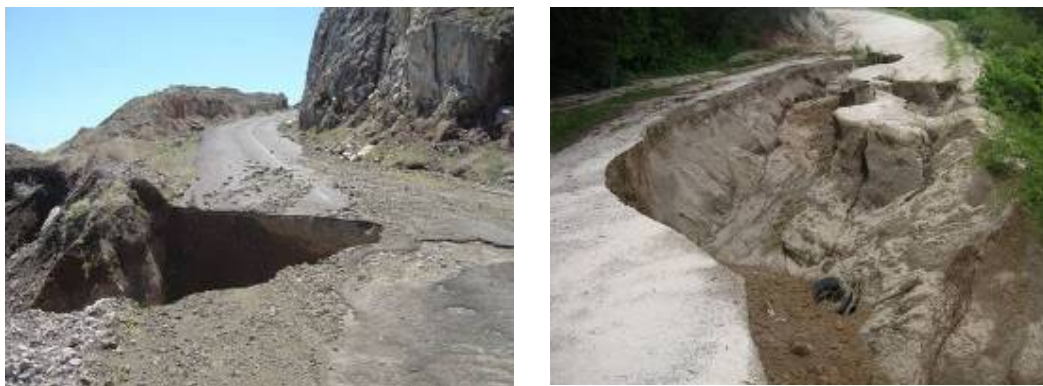
Figura 2.81 Daños en caminos rurales y alimentadores
