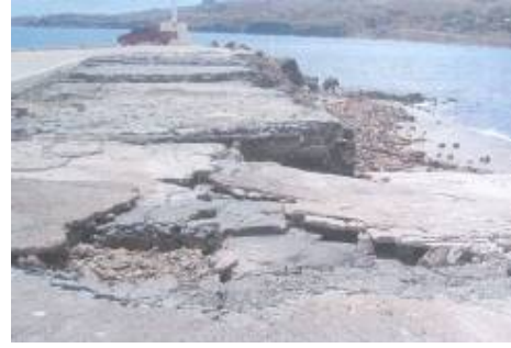
Daños en espigón de protección
