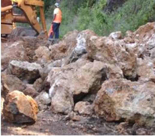
Figura 2.152 Derrumbe en infraestructura carretera
