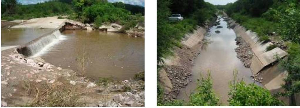
Figura 2.131 Daños en infraestructura hidroagrícola
