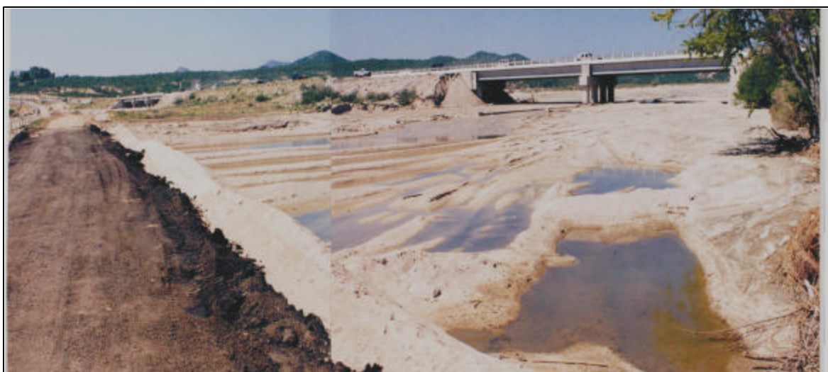
Figura 2.47 Efectos de los desbordamientos sobre el puente del arroyo “El Tule”
