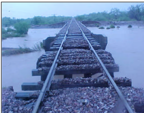
Figura 2.20 Daños ocasionados por las lluvias torrenciales, generadas por Juliette, en la infraestructura de transporte
