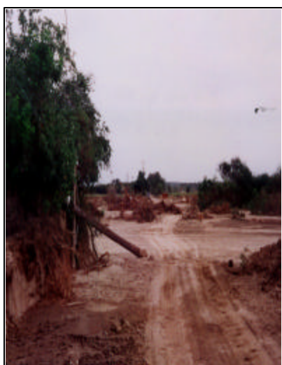
Figura 2.41 Daños en la infraestructura de la CFE
