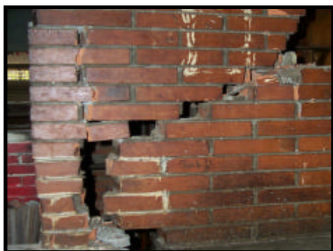
Figuras 3.3 Daños estructurales severos en el mercado municipal
