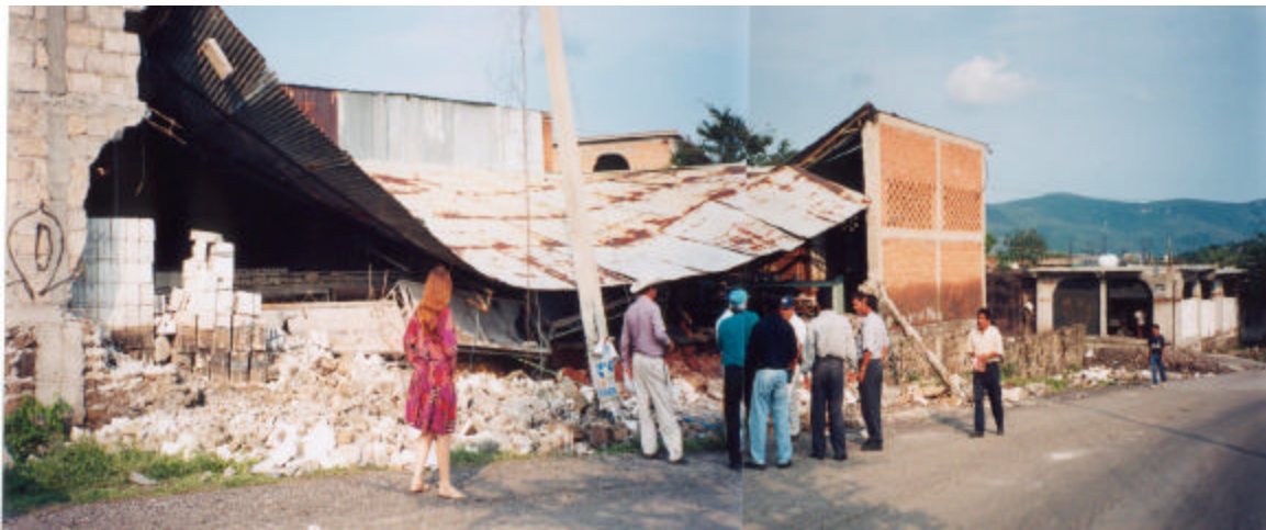
Pared derribada de una fábrica de cerámica, por la acción del agua que penetró a ésta, colonia Las Cumbres, municipio de Emiliano Zapata
