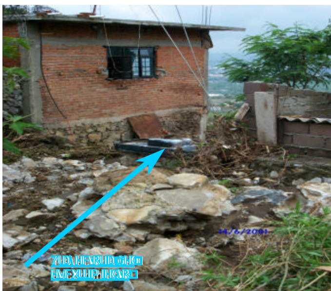
Figura 2.65 Lugar donde el agua derribó un cuarto habitado. Vista desde aguas arriba
