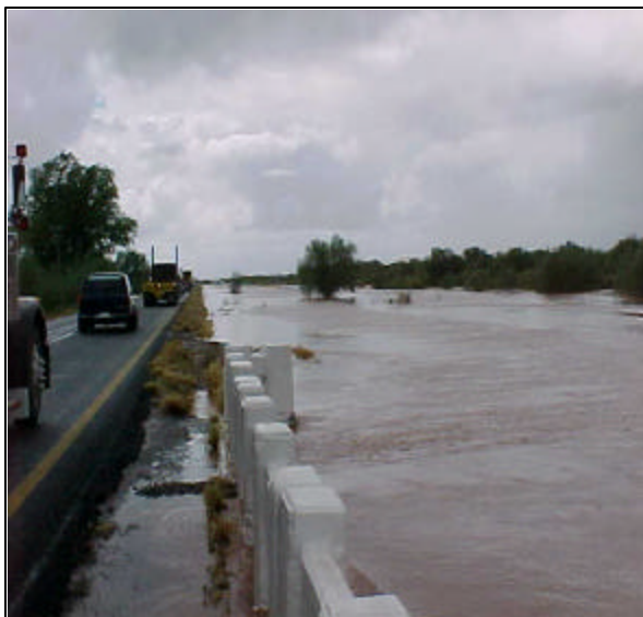
Figura 2.18 Tramo Obregón –Guaymas Inundación en el KM 40+150 - 41+450
