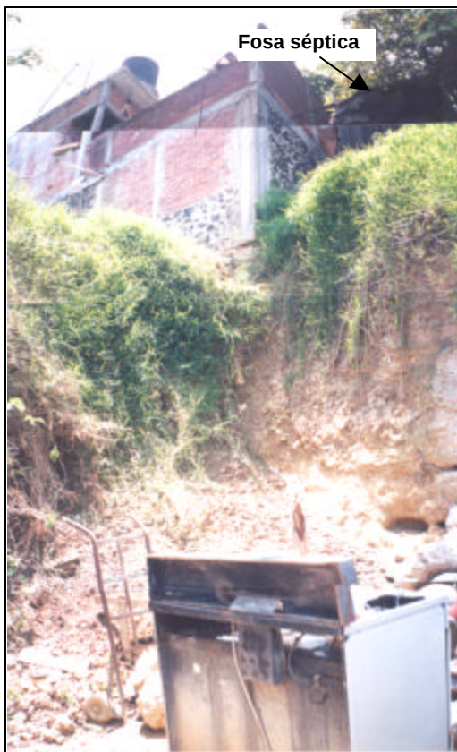
Figura 2.62 Cortes verticales sin protección alguna
