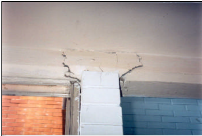
Figura 2.70 Grietas en la unión del castillo-dala en un Kinder debido a los asentamientos diferenciales
