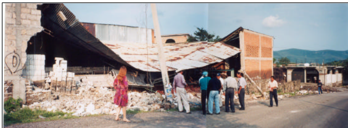
Figura 2.72 Pared derribada de una fábrica de cerámica, por la acción del agua que penetró a ésta, colonia Las Cumbres, municipio de Emiliano Zapata
