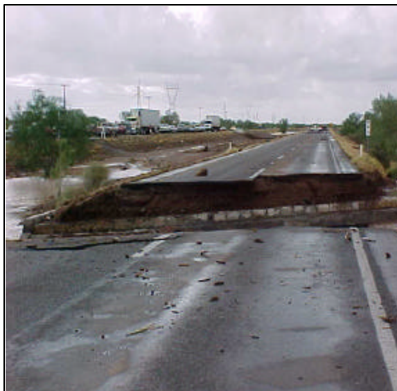
Figura 2.19 Tramo Obregón – Guaymas. Puente dañado que presentó 3 claros de 7 m c/u, de los cuales uno quedó en pie y tuvo que ser demolido por seguridad
