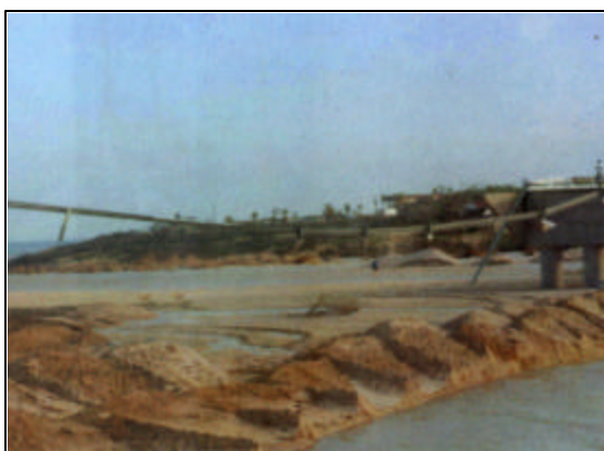
Figura 2.43 Puente "Los Tules" ubicado en el Km 15 + 250 del tramo Cabo San Lucas – La Paz en el que se observa la destrucción de los terraplenes de acceso
