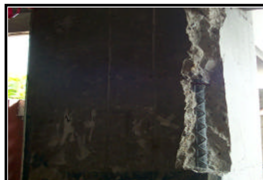
Figura 3.4 Daños estructurales severos en el mercado municipal
