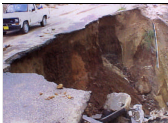
Figura 2.44 Daños en los Km 120+000 al 122+ 000 del tramo Cabo San Lucas – La Paz
