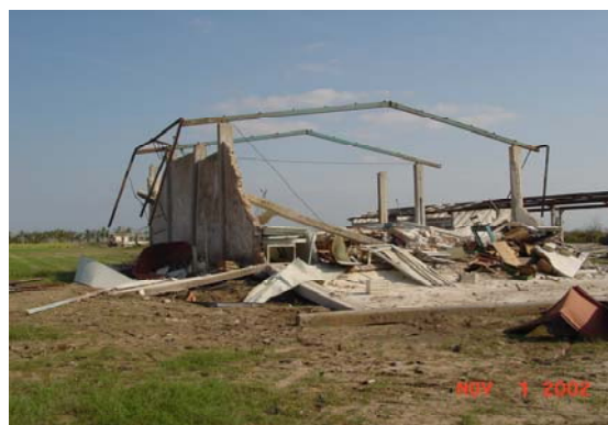
Figura 2.119 Colapso parcial de un edificio escolar
