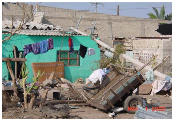
Figura 2.115 Daños en postes eléctricos
