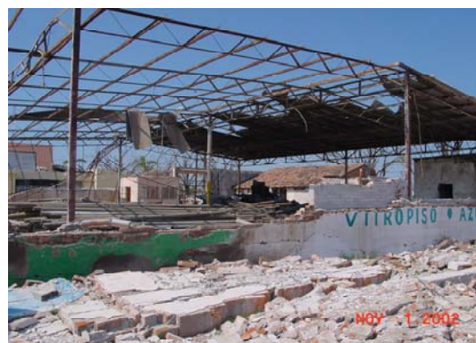
Figura 2.117 Desprendimiento del techo de una nave industrial
