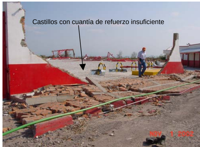
Figura 2.120 Daños observados en edificios escolares
