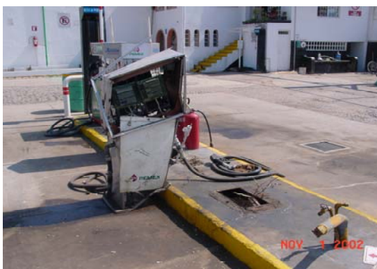
Figura 2.114 Daños en gasolineras
