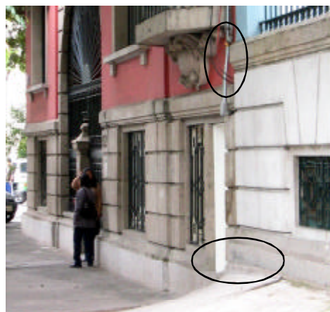
Asentamiento diferencial entre edificios vecinos.
