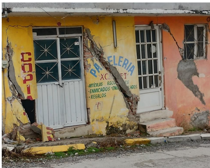
Daño estructural en vivienda producto de un deslizamiento de ladera en la zona norponiente del municipio de Chilpancingo de los Bravos, Guerrero
